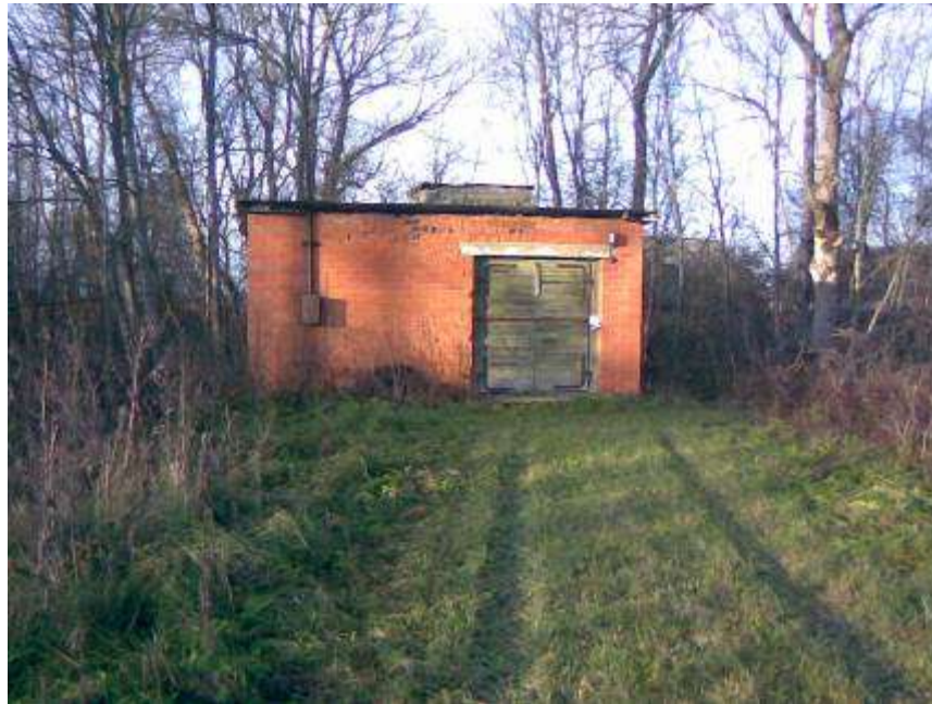
Rõude puurkaev-pumpla PK
